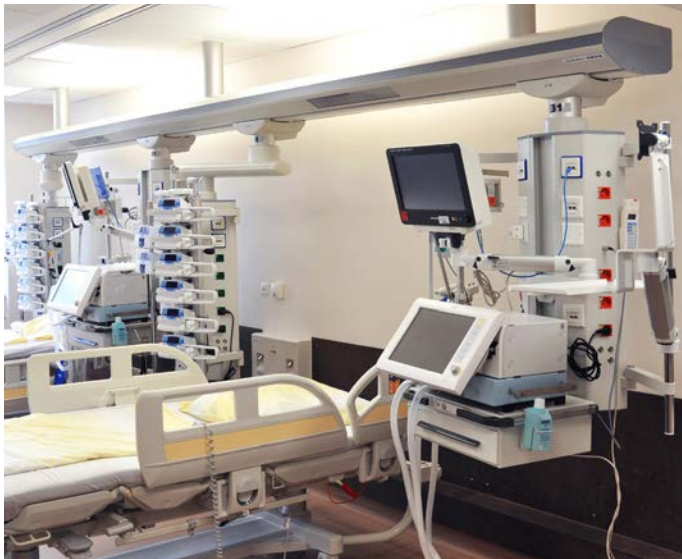
fig. 072 | moduflex nova, BSP 2500 centralised St. Vincenz-Krankenhaus, Limburg
